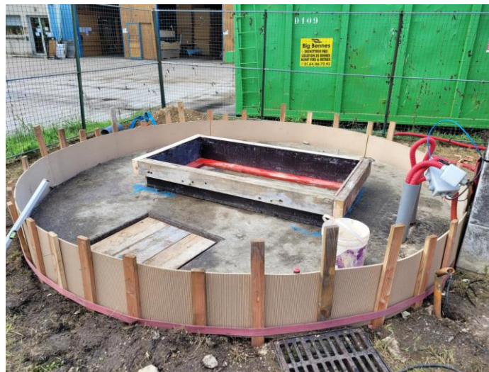
Photo du coffrage monté avant de couler la dalle du poste ampère
